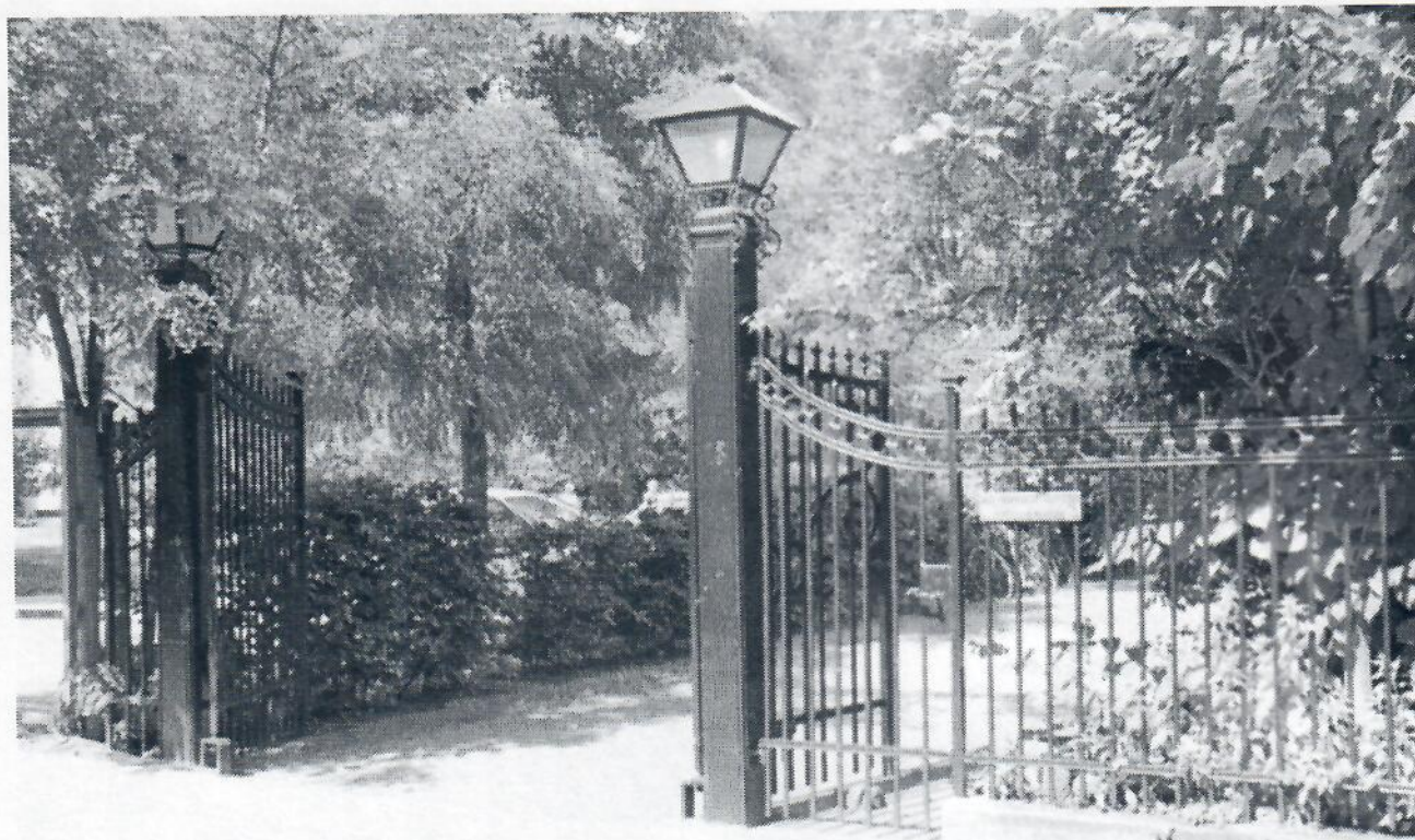
Den flotte smedjærnsport blev reddet i et samarbejde med Frederiksberg Kommunes ungdomsværksted. Den var i en sørgelig forfatning, hvor stolperne var rustet halvt igennem. Ungdomsværkstedet kunne godt bruge projektet til meningsfyldt igangsættende arbejde. Fondet betalte materialeudgifterne, opgravning og kørsel, medens ungdomsværkstedet lagde tid til. Det tog godt nok et halvt år med projektet, men uden samarbejdet havde port og hegn i dag været borte.
